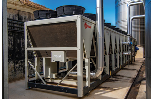
Kälteaggregat mit Wärmerückgewinnung
