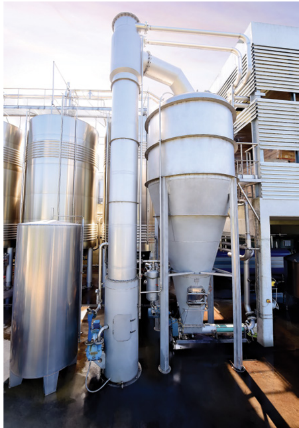
Entspannungskammer 20 t/h mit Kondensator
