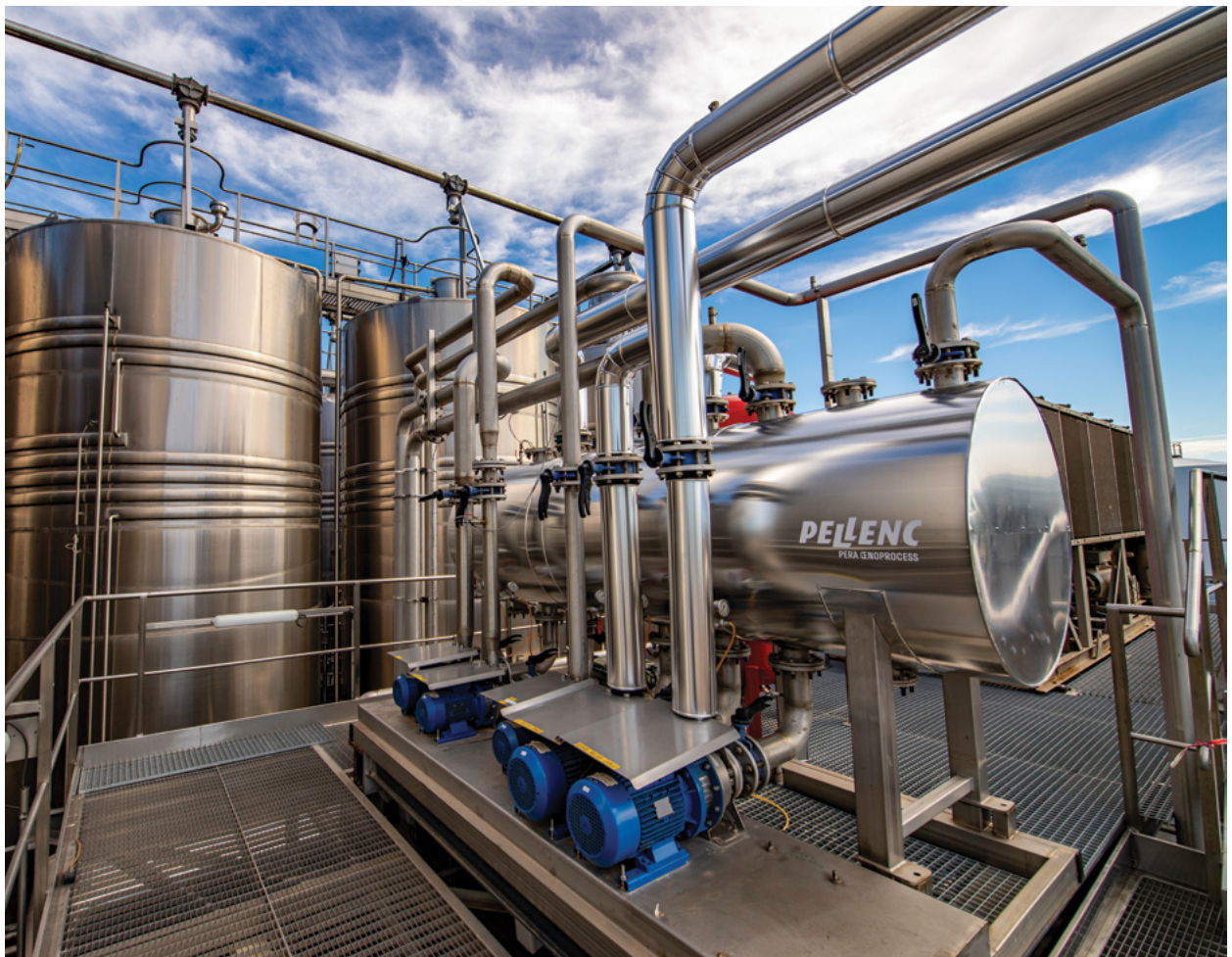
Pufferspeicher und Wärmeverteilungsmanagement
