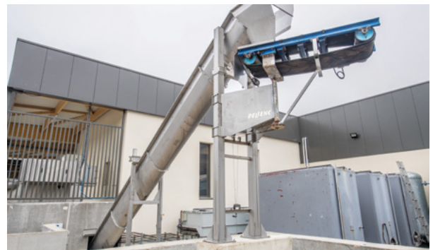
Tresteraustrag per Förderschnecke
