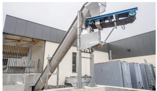
Tresteraustrag per Förderschnecke
